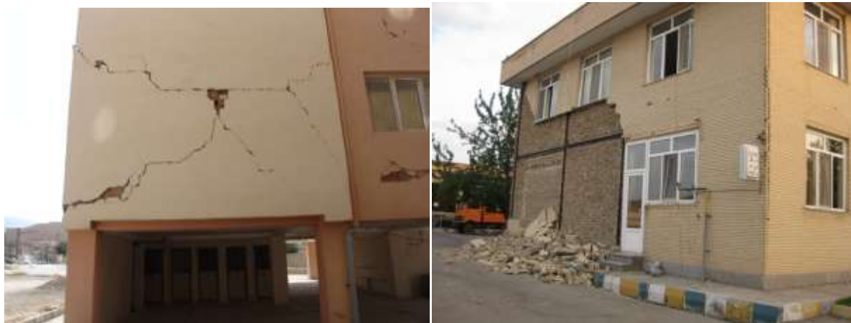
شکل ت ۹-۴- آسیب وارد شده به دیوارهای غیرسازه‌ای (الف) ترک‌های افقی و مورب در دیوار غیرسازه‌ای (ب) عدم مهار مناسب دیوار نما، جداشدن و ریزش دیوار در زمان زلزله
